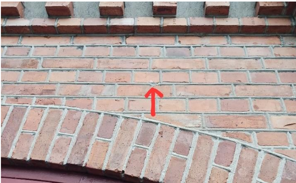
Hålen som blivit efter fästena från byggställningen har lagats med Concrete Fix som har samma färg som murbruket och fick ett diskret slutresultat. (Foto Magnus Degerstedt 23.09.27)
