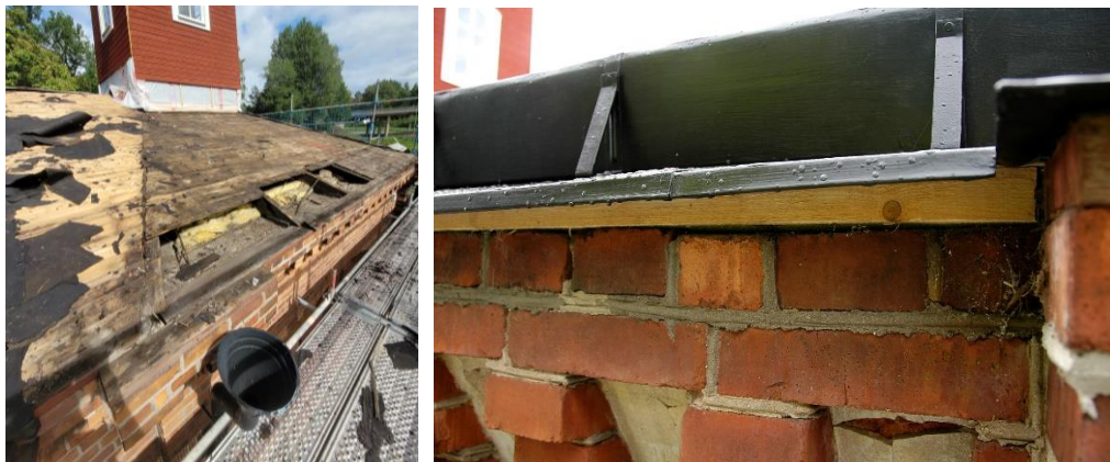
Till vänster: Råsponten under plåttaket var i sämre skick än vad man trott. (23.08.10)
