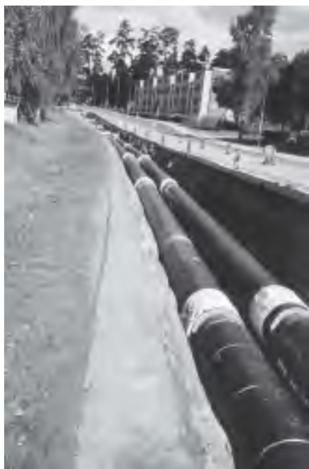
Transiteringsledning för fjärrvärme (Sigmaområdet). Foto: Allan Andersson
