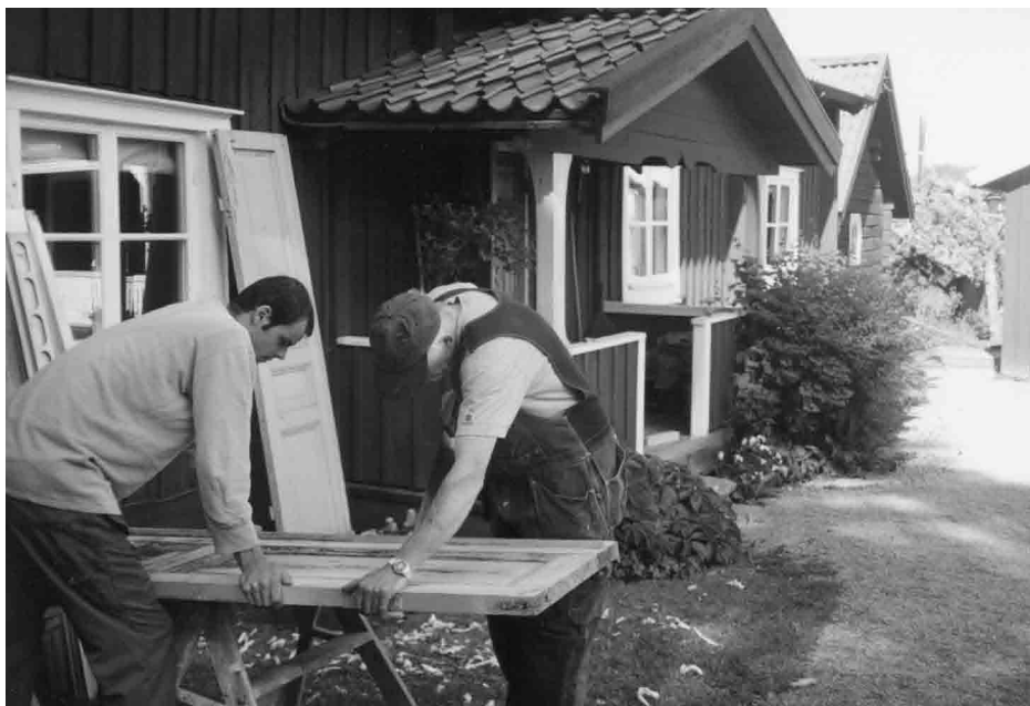
Renovering av prästgårdsflygeln på gammalt sätt och med gamla metoder. Här förminskas de gamla spegeldörrarna som ska sitta innanför ytterdörrarna.
