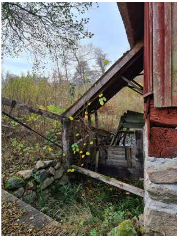
Det stora vattenhjulet under taket är numera i dåligt skick. Sågmöllans trästomme renoverades och möllan fick nytt vasstak 2019.
