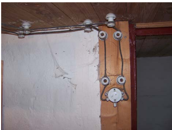
En annan del av elkopplingarna i Säflacka skola. Kablarna, som idag är plastgjutna, var inlindade i textil. På bilden ser man också en strömbrytare. Foto: Sven Jensén 2008.
