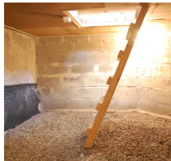
Oinredd källare, saknar golv och väggbehandling.
