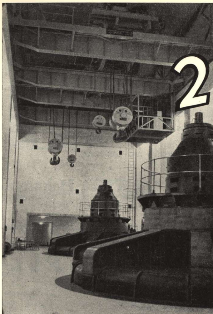
Maskinhal-en vid Krångede kraftverk.
