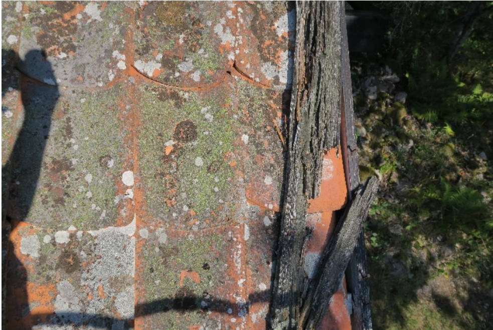
Vindbrädor i behov av renovering.
