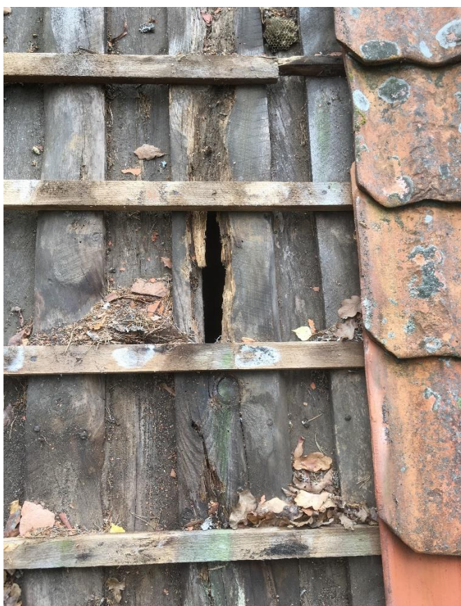
Undertaket var på vissa ställen fuktskadat och var i dåligt skick. Foto: Sören Pettersson
