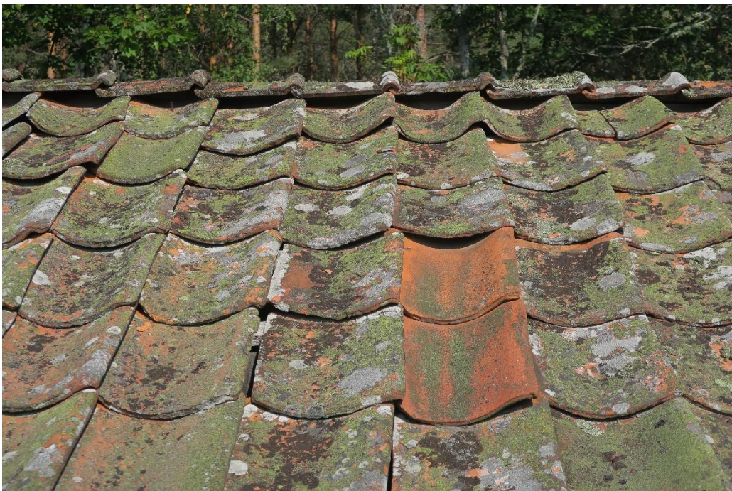
Framsidan mot söder. Pannorna hade lossnat och låg delvis löst. Vissa tegelpannor var kompletterade med en djupare kupa.
