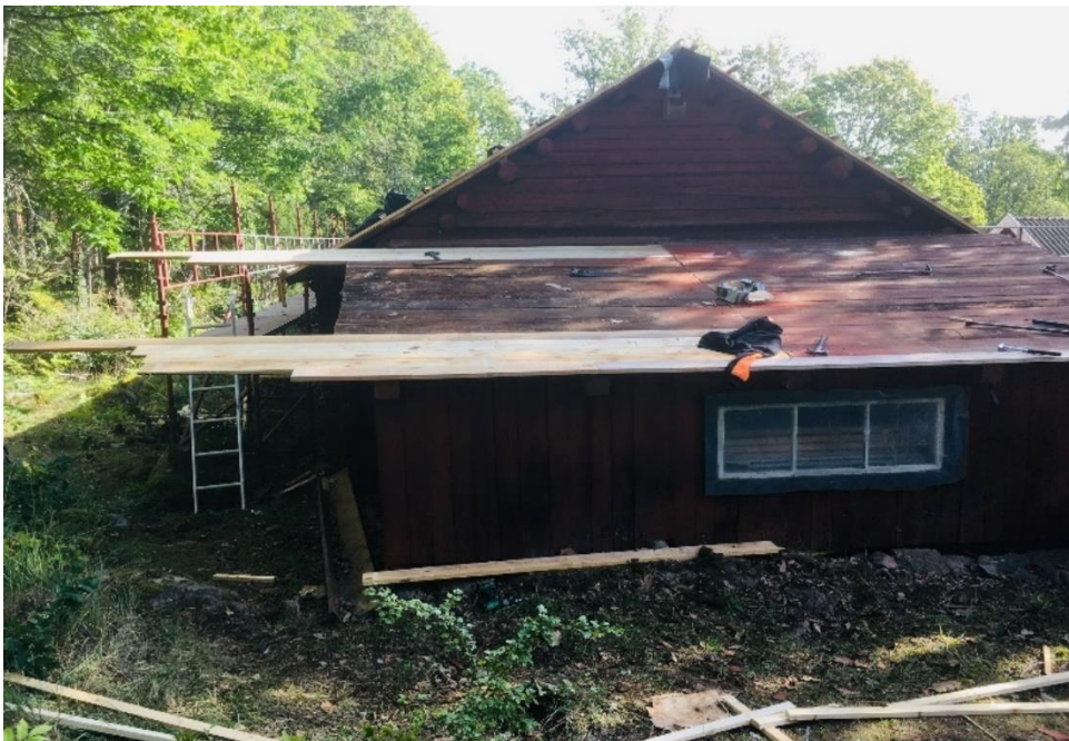
Undertaket på delen mot väst var i behov av renovering. Undertaket lagades delvis med virke i samma dimension och utförande. Foto: Sören Pettersson
