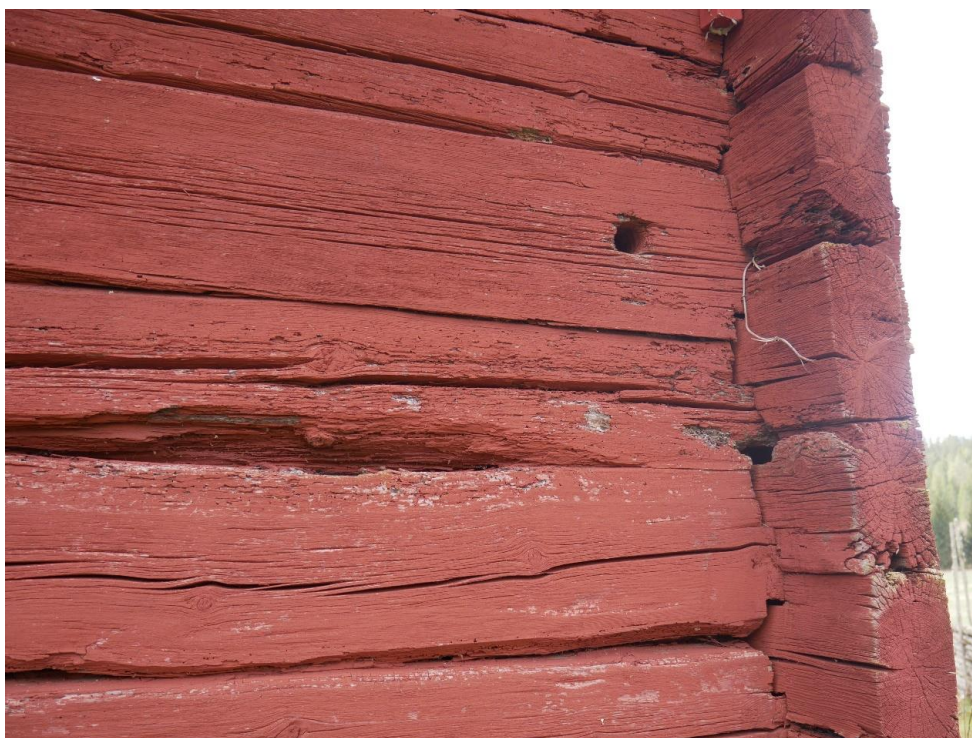
Portlidrets norra sida. Rötskador i timmer som bildar fickor. Knutar med mindre skador.
