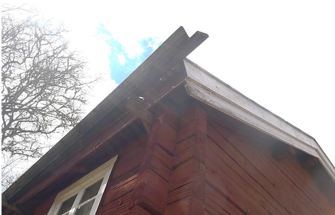
Ytterligare en bild på hängrännan av trä är rötskadad samt vindskivorna på norra sidan.
