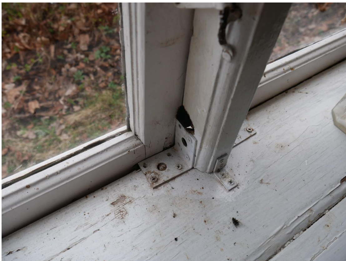
Fönster i köket. Rötskada i mittposten.
