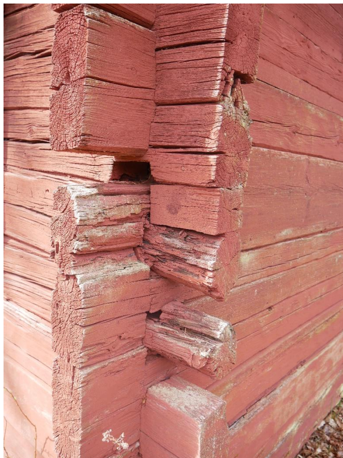
Knutkedja på Idastugans nordvästra hörn med skadade knutar.
