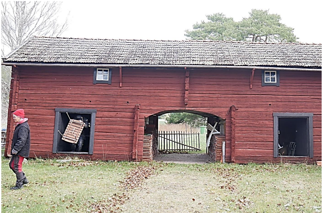
Portlidret där södra takfallet är i behov av omläggning. Hänggrännen är utförd av en urholkad stock och går utanför byggnaden vilket minskar risk för skvätt på timret.
