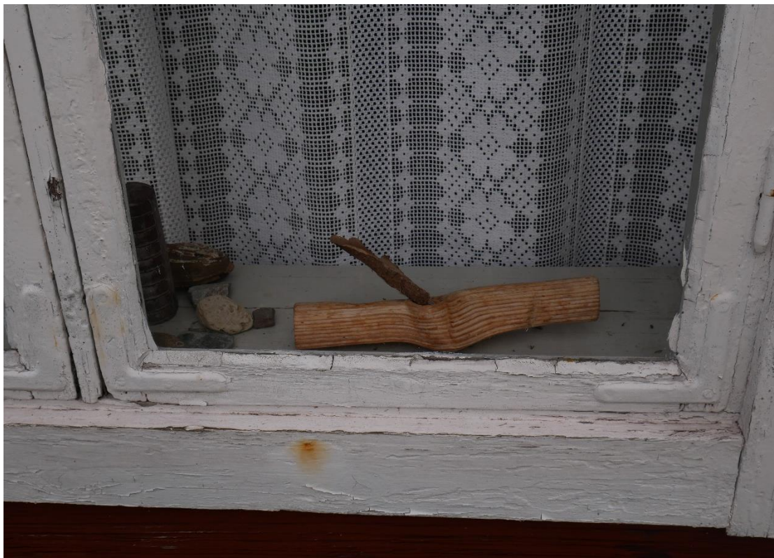
Fönsterbågar på bottenvåningen har sprucket kitt och är i behov av skrapning, kittning och målning.
