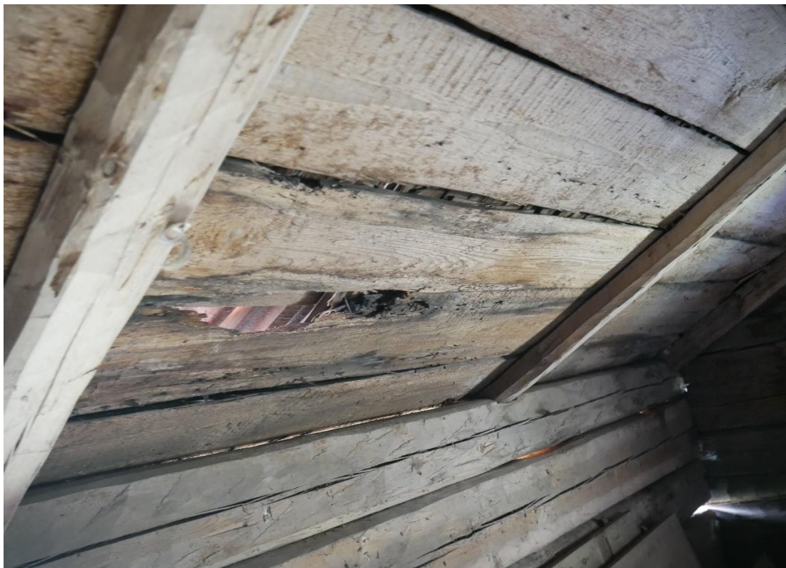
Portlidret. Brädor i södra takfallet har rötskador. Även takstickorna är bort på vissa ställen
