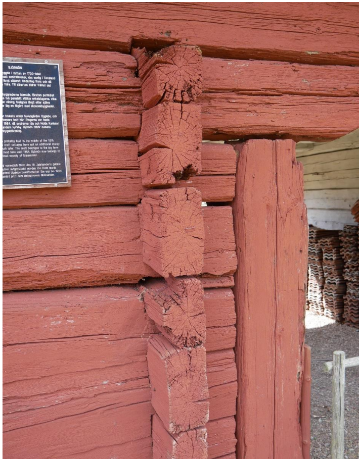
Portlidret med rötskador på knutar.
