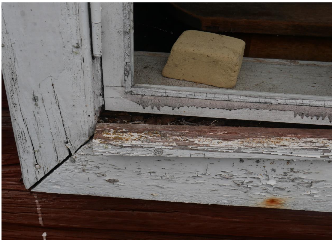
Fönsterbåge med sprucket kitt. Fönsterbräda för avrinning rötskadad. Foder rötskadat och sprucket.
