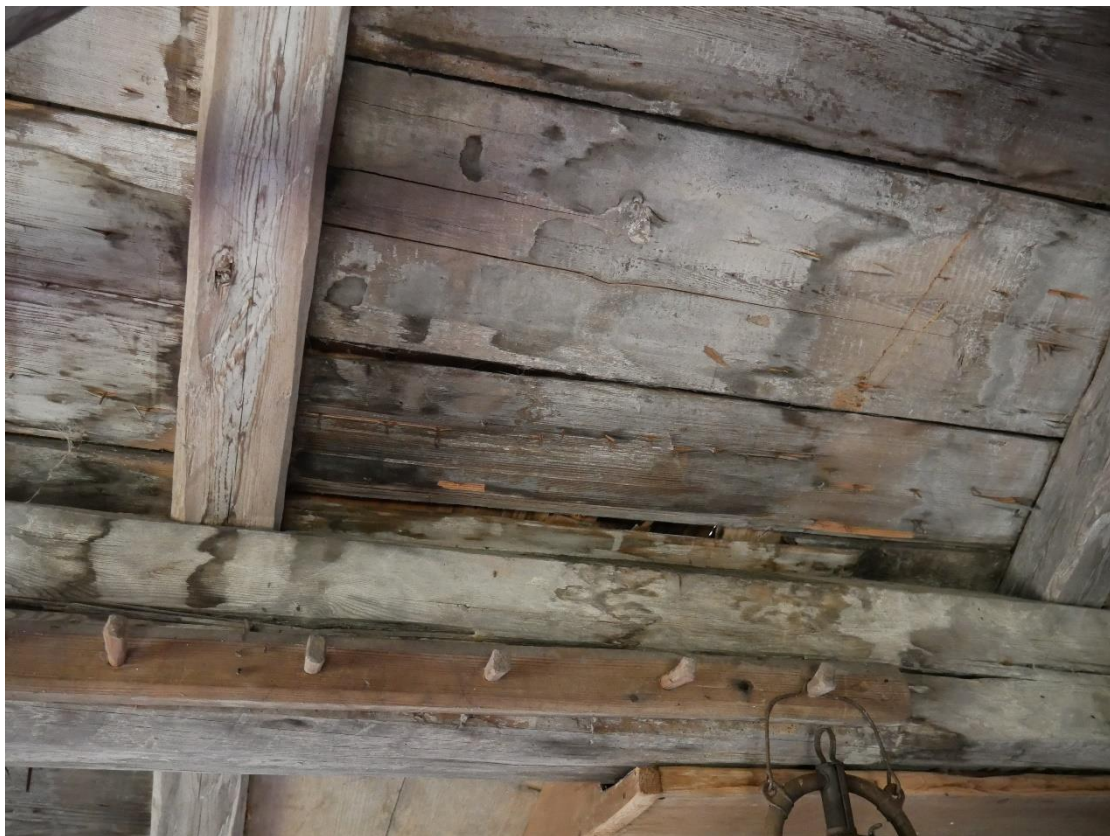
Läckage som visar att östra takfallet inte är tätt.
