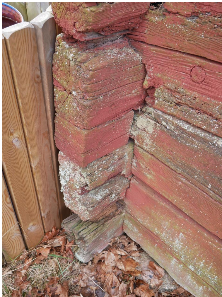
Rötskadade knutskallar i NO knutkedjan.
