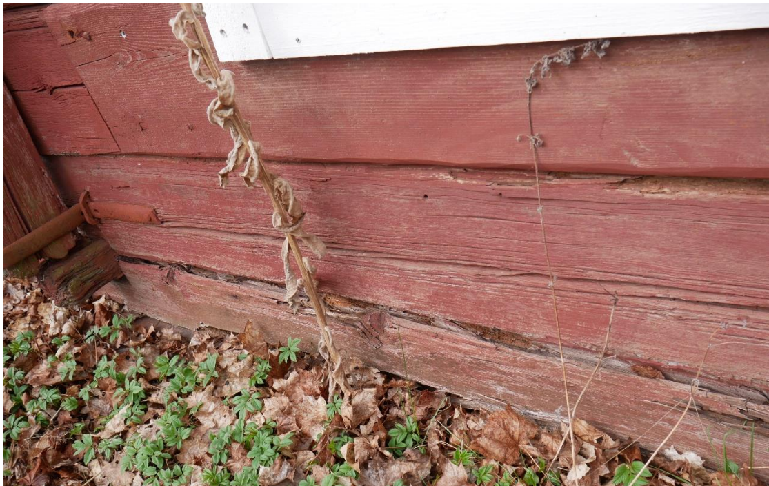
Rötskadad syll under köksfönstret.
