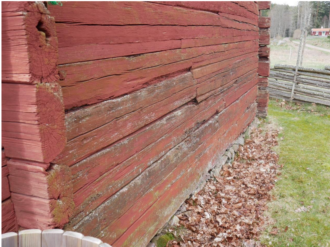
Norra gaveln har flera äldre (1970-tal) lagningar samt att det finns nya rötskador i timret.
