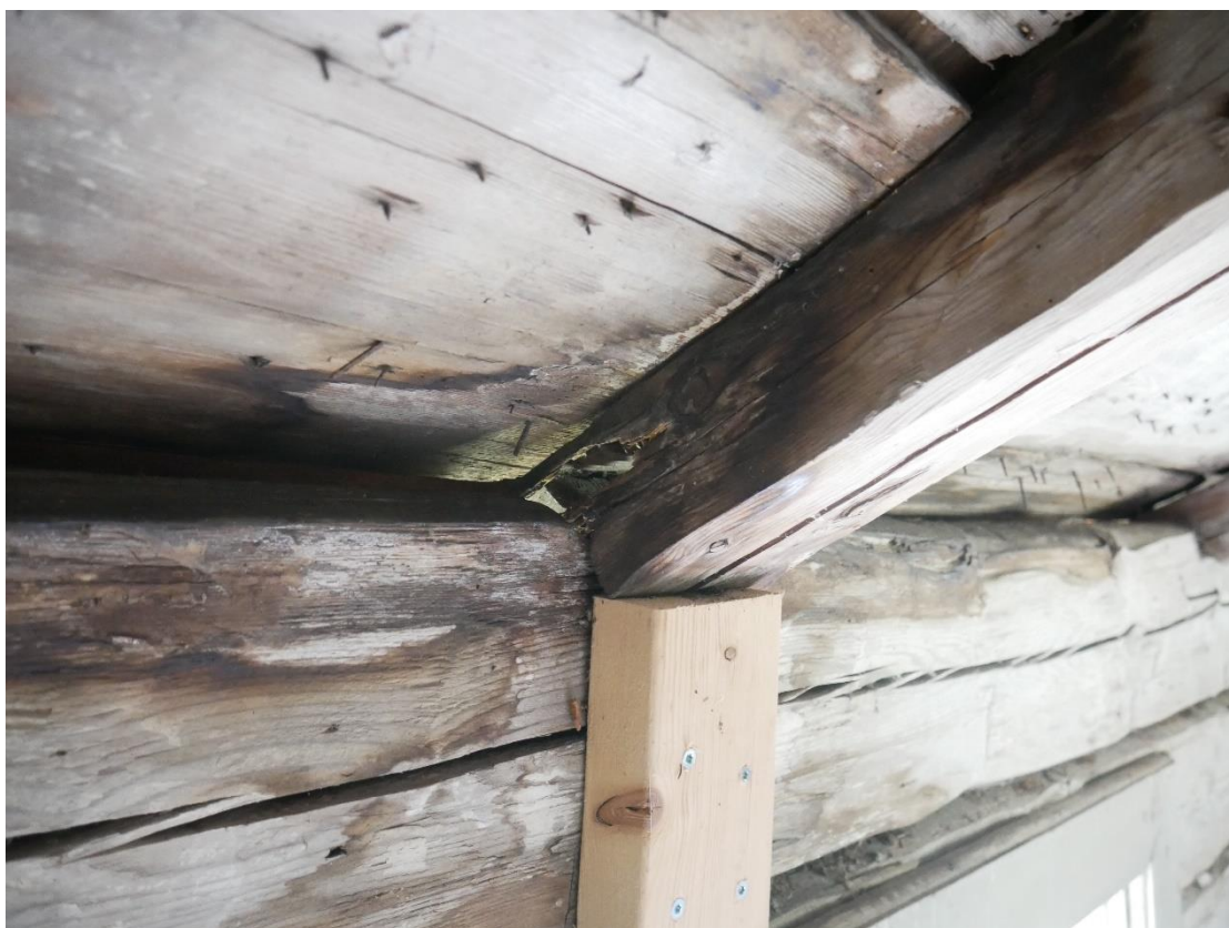
Rötskadad sparr som har säkrats upp med ett stöd.
