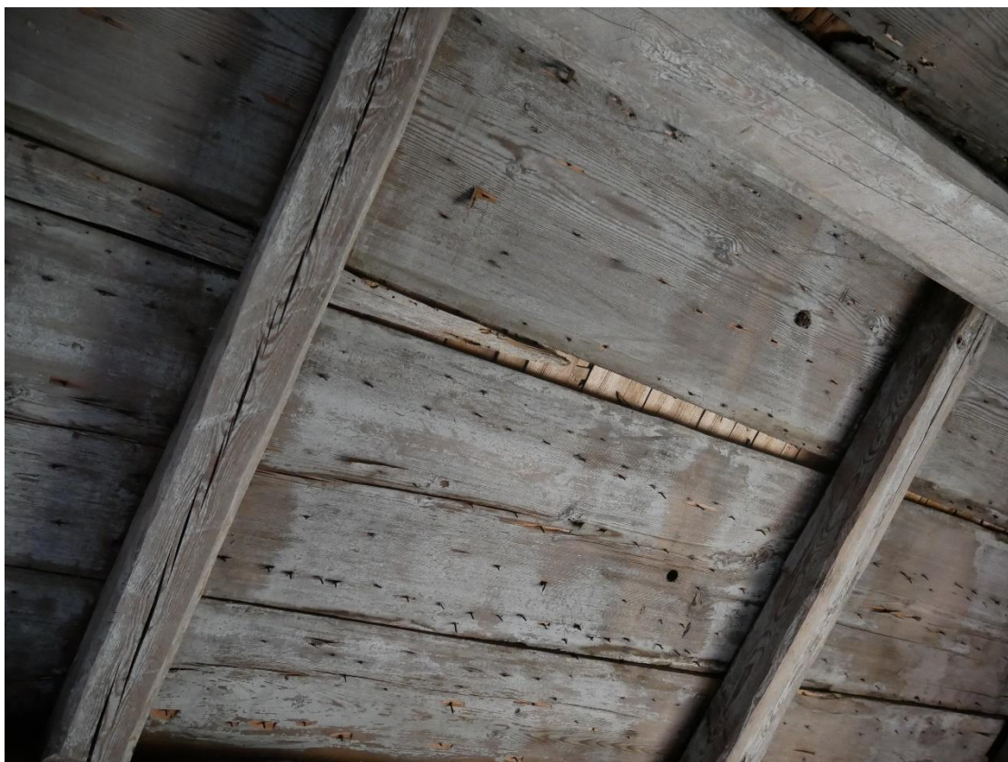
På flera ställen finns springor och öppningar där stickeläggnen är synlig.
