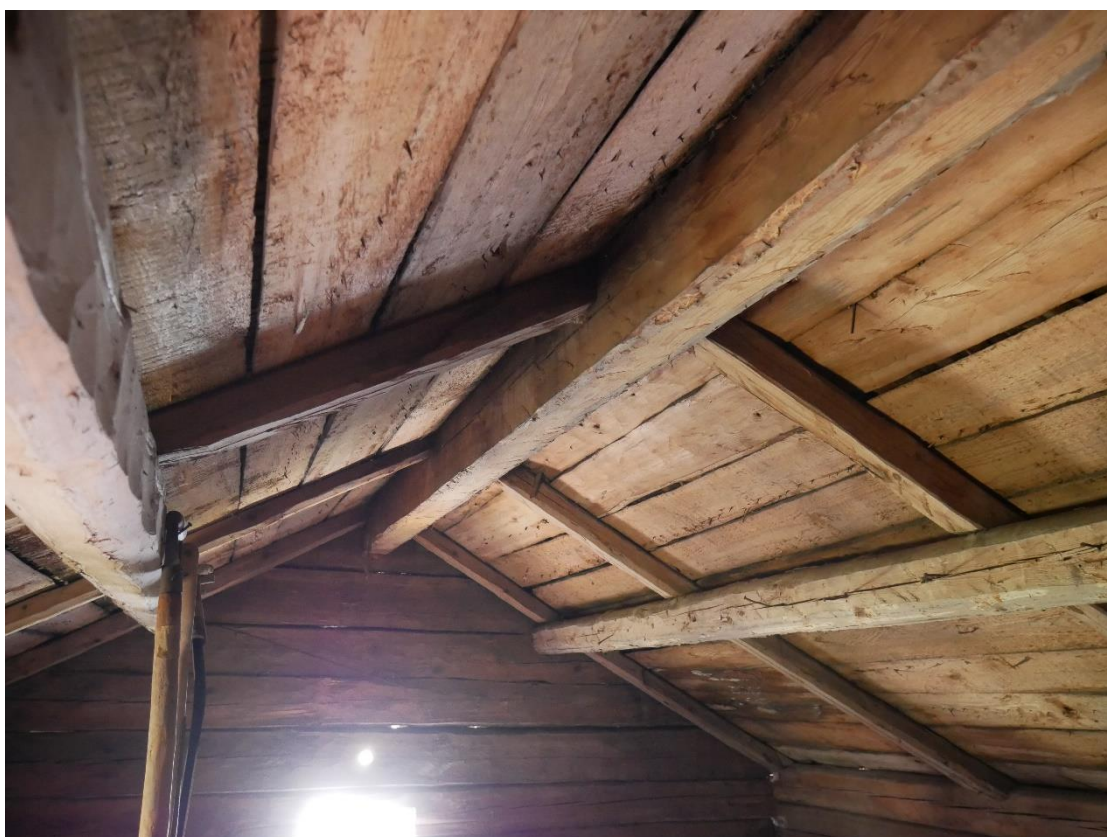
Portlidret med åstaket. Längst ner till höger syns en rötskada i undertaket.
