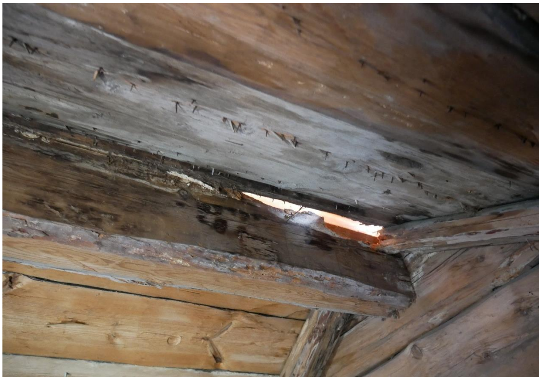
Portlidret. Åsen har rötskador på ovansidan och virke i dess anslutning är också rötskadat.
