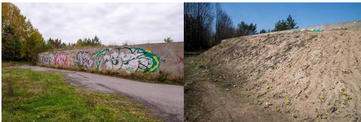
Cementvägg före åtgärd och cementvägg med sandvall.
