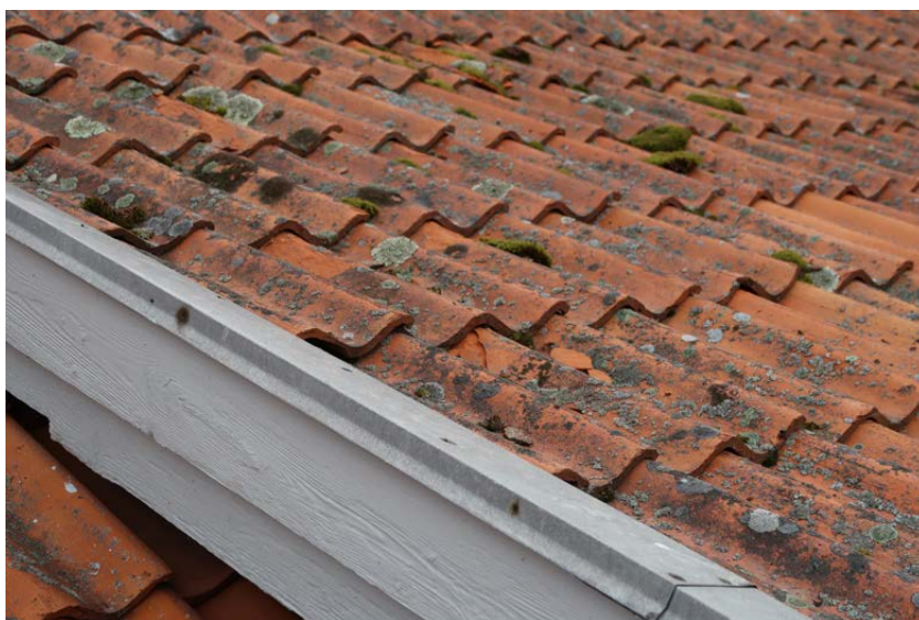
Detaljbild på de tvåkupiga lertegelpannorna på det sydöstra takfallet före åtgärd. Majoriteten av pannorna var spruckna och i dåligt skick.
