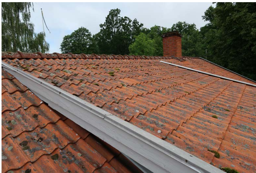
Övre delen av sydöstra takkupans tak före åtgärd.
