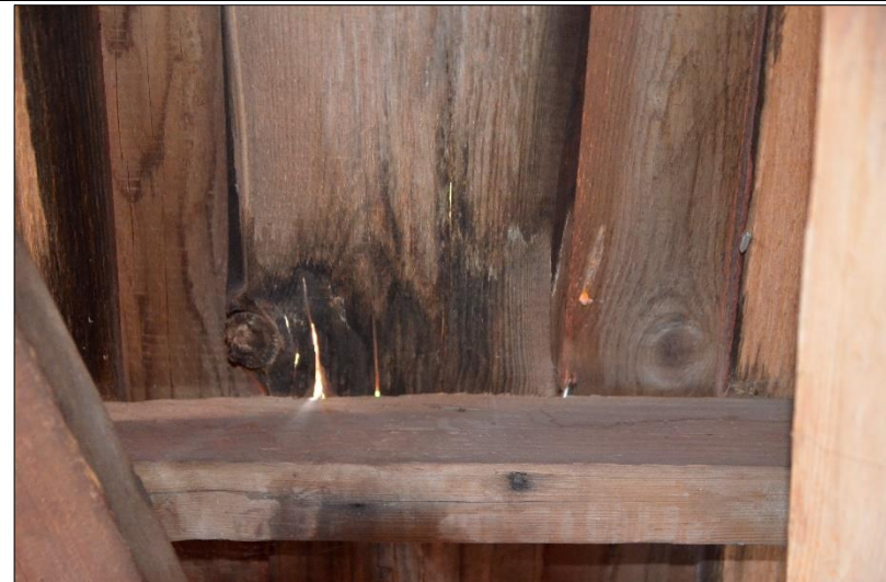
Röt-skadad och sprucken panel, plan 2, åtgärdas 2021. Foto: AP, 2020-09-17
