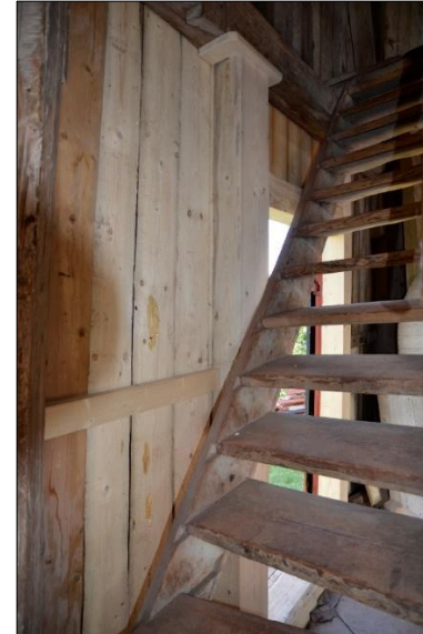
Nya panelbrädor intill dörr mot väster. Foto: AP, 2020-09-17
