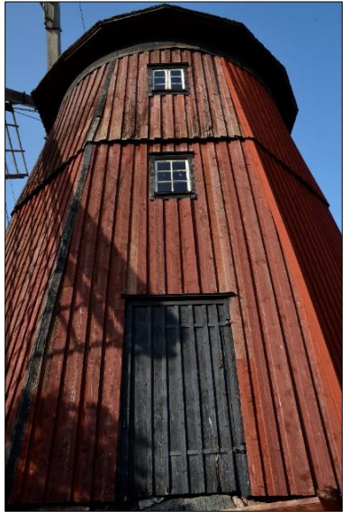
Fasad med röt-skadad lockpanel mot öster, åtgärdas 2021. Foto: AP, 2020-09-17
