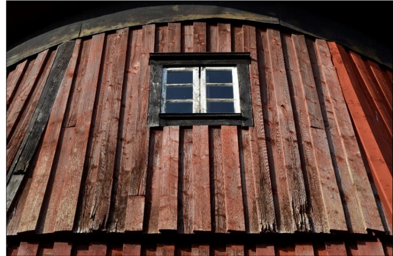
Röt-skadad lockpanel mot öster, åtgärdas 2021. Foto: AP, 2020-09-17
