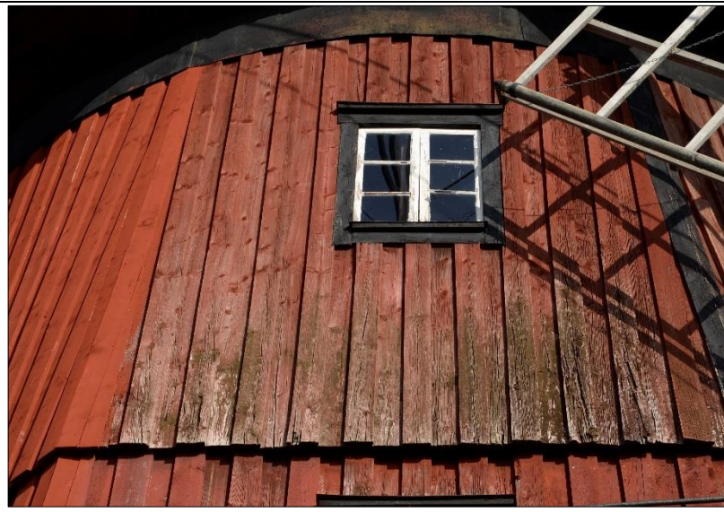
Rötskadad lockpanel mot sydväst, plan 2, åtgärdas 2021. Foto: AP, 20200917
