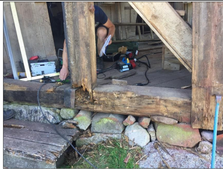
Rötskador i träskele, syllstock, karm, dörr mot väster. Foto: Allan Rodbe, 20200612
