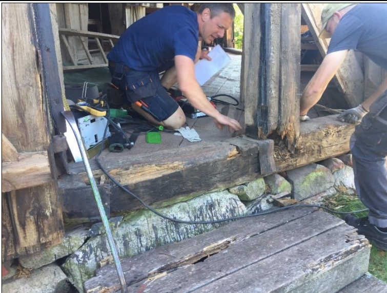
Rötskador i träskele, syllstock, karm, dörr mot väster. Foto: Allan Rodbe, 20200612
