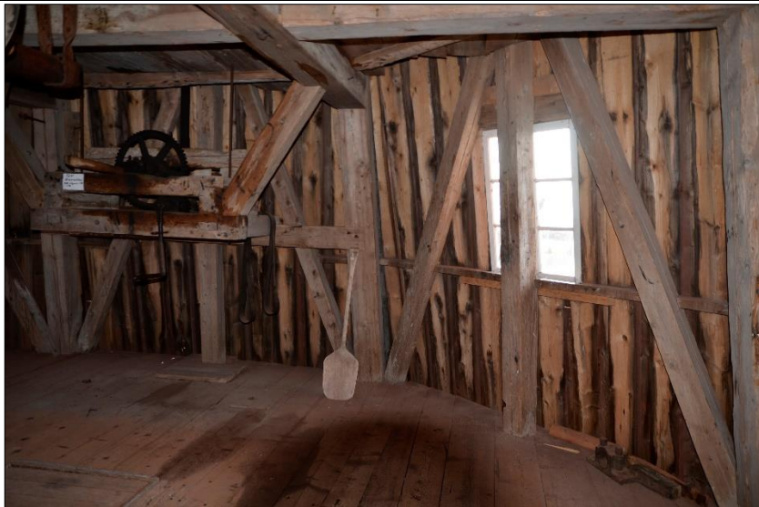
Röt-skadad panel, plan 2, åtgärdas 2021. Foto: AP, 2020-09-17
