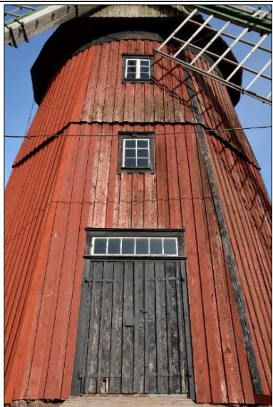
Fasad med rötskadad lockpanel mot sydväst, åtgärdas 2021. Foto: AP, 2020-09-17
