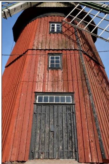
Fasad mot sydväst med rötskadad lockpanel, 2020-09-17
