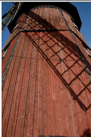
Rötskadad lockpanel på fasad mot sydost, 2020-09-17
