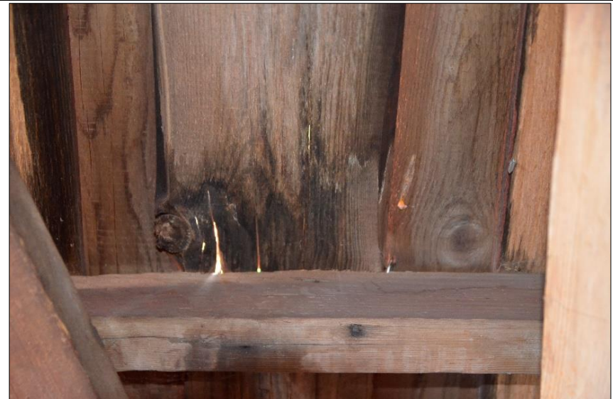
Rötskadad och sprucken panel, plan 2, 2020-09-17
