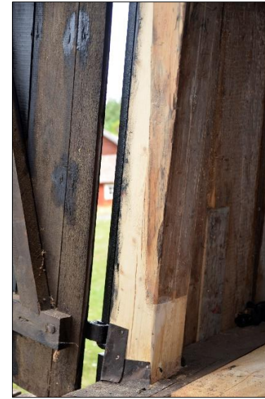
Dörrkarmens timmerstomme har skarvats i intill pardörr mot sydväst, 2021-07-09
