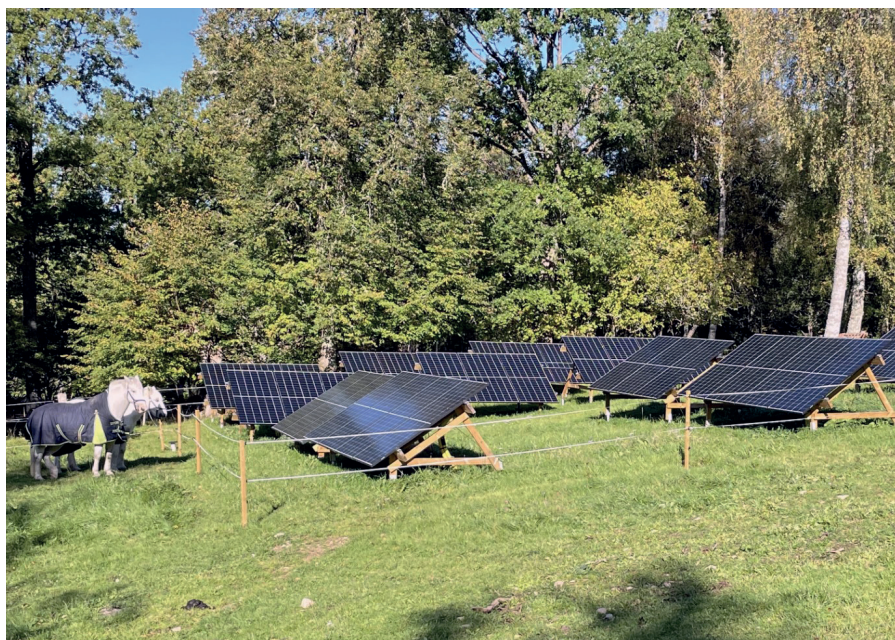
Solceller hos familjen Ståhl i Bråt. Om man inte har lämpligt tak är solceller på marken ett gott alternativ. Här är solcellerna riktade åt både sydost och sydväst. Foto Pierre Ståhl
