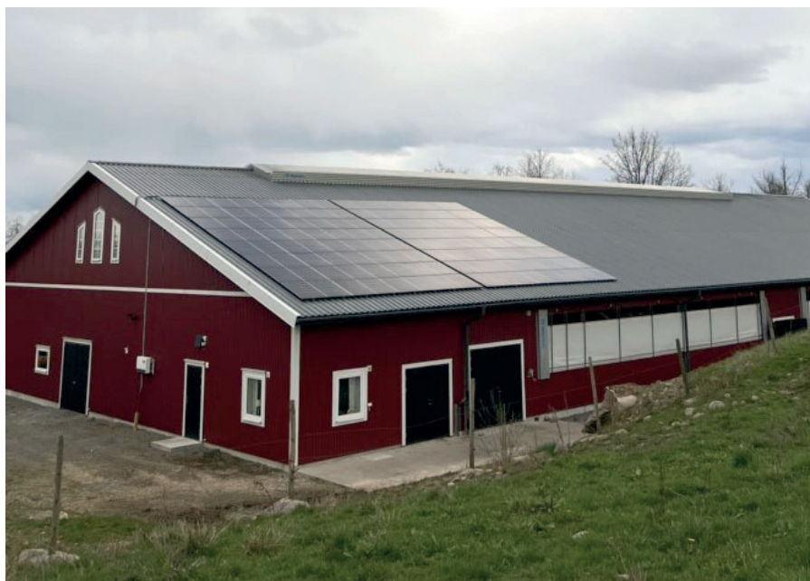
Solceller i Holma. Anläggningen är uppskattningsvis den största i socknen och ger upp till 26 kW. Foto TA Sol&Montage AB
